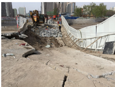
图 3 基坑周边地表塌陷
