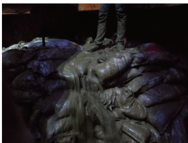
图 2 地连墙接缝渗水并携泥带砂
